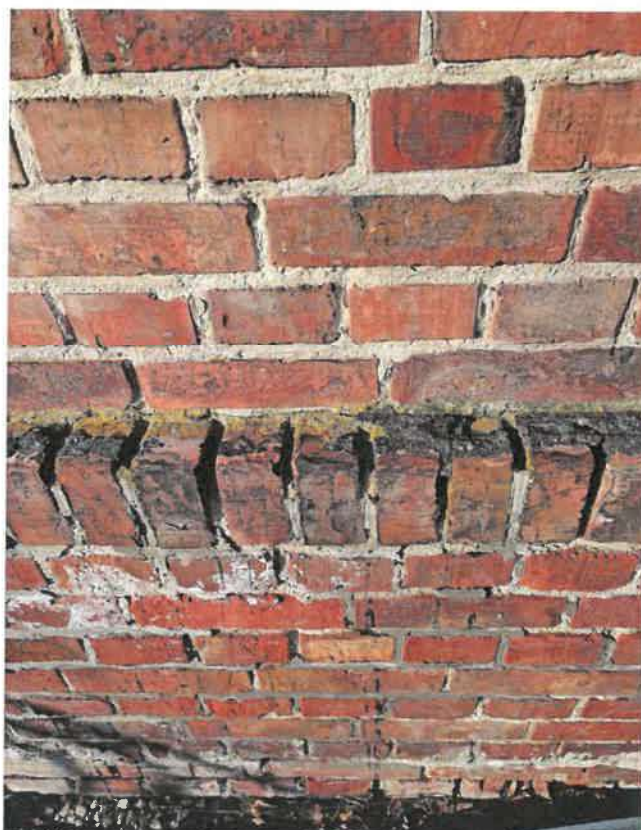
Zdj. nr 16 – Ubytki spoinowania na górze cokołu
