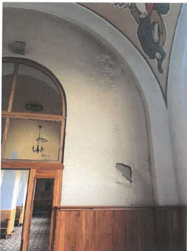
Zdj. nr 13 – Ślady zawilgocenia i duże ubytki tynku na ścianie wewnątrz kaplicy
