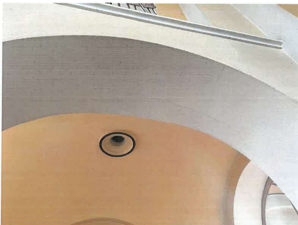
Zdj. nr 19 – Pęknięcie łuku nad przejściem pomiędzy nawą główną a boczną
