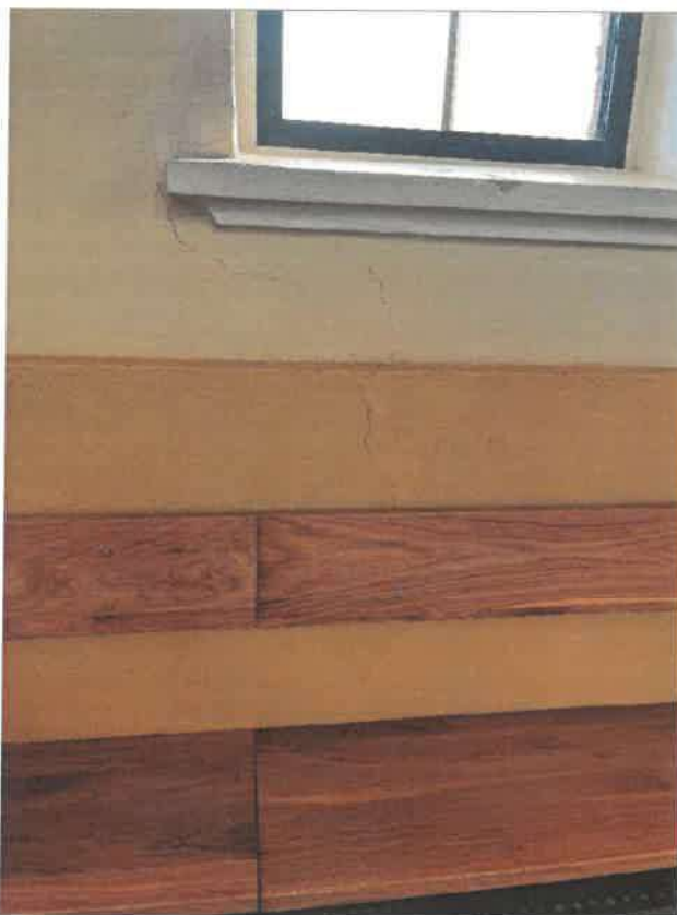
Zdj. nr 11 – Pęknięcie biegnące od podokiennika przez ścianę
