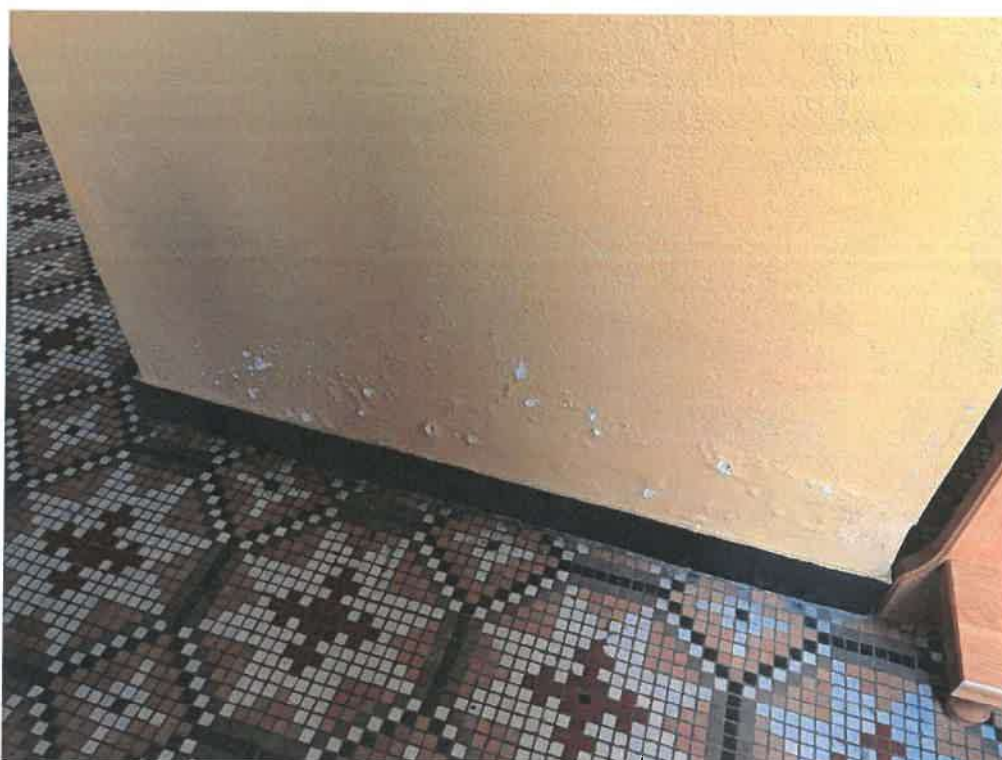
Zdj. nr 12 – Rozwarstwienia i spęcherzenia tynku w rejonie cokołu wewnętrznego
