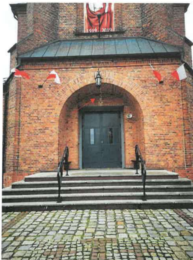
Zdj. nr 15 – Pęknięcie ściany nad wejściem głównym
