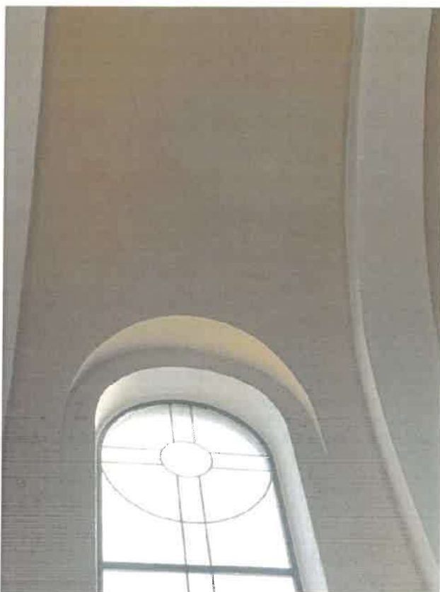
Zdj. nr 20 – Pęknięcie nadproża łukowego nad oknem nawy głównej
