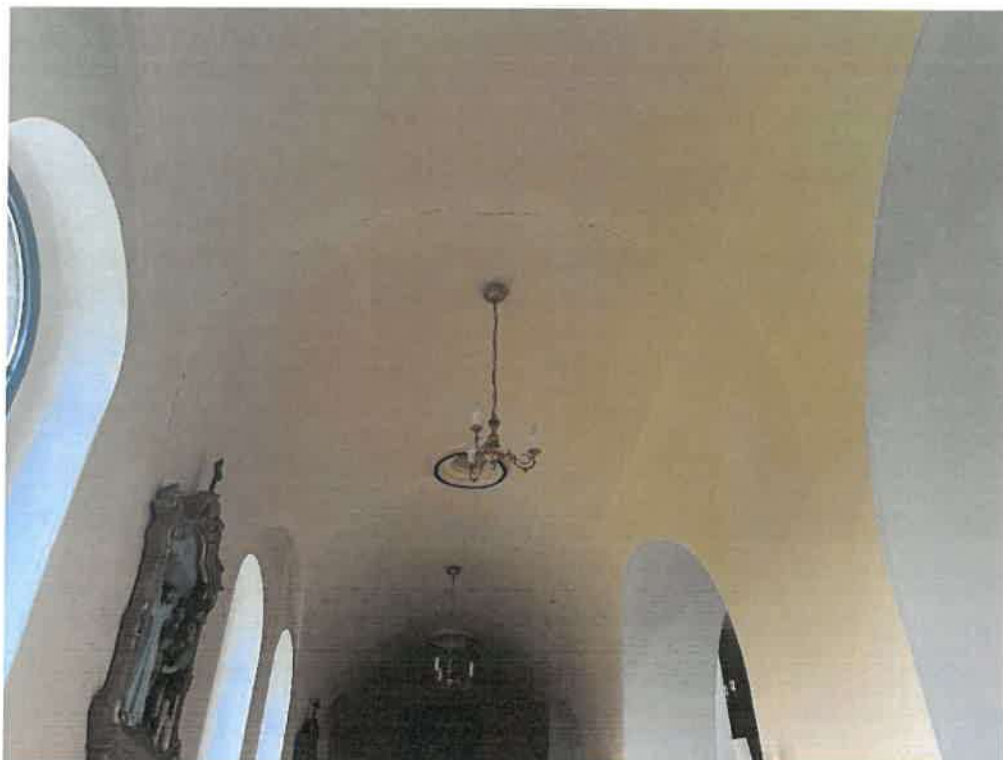
Zdj. nr 18 – Pęknięcia na sklepieniu nawy bocznej
