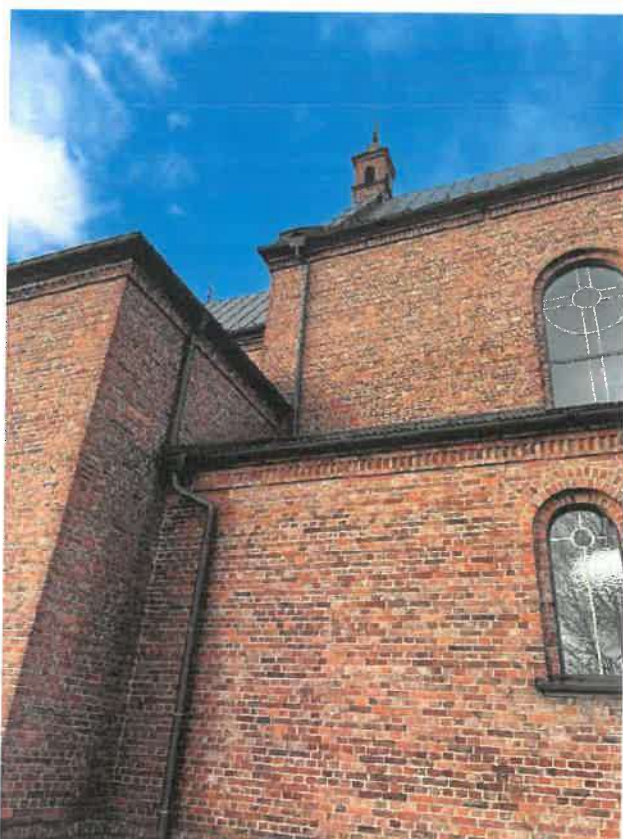
Zdj. nr 22 – Połączenie rynny i rury spustowej narażone na przelewanie wody
