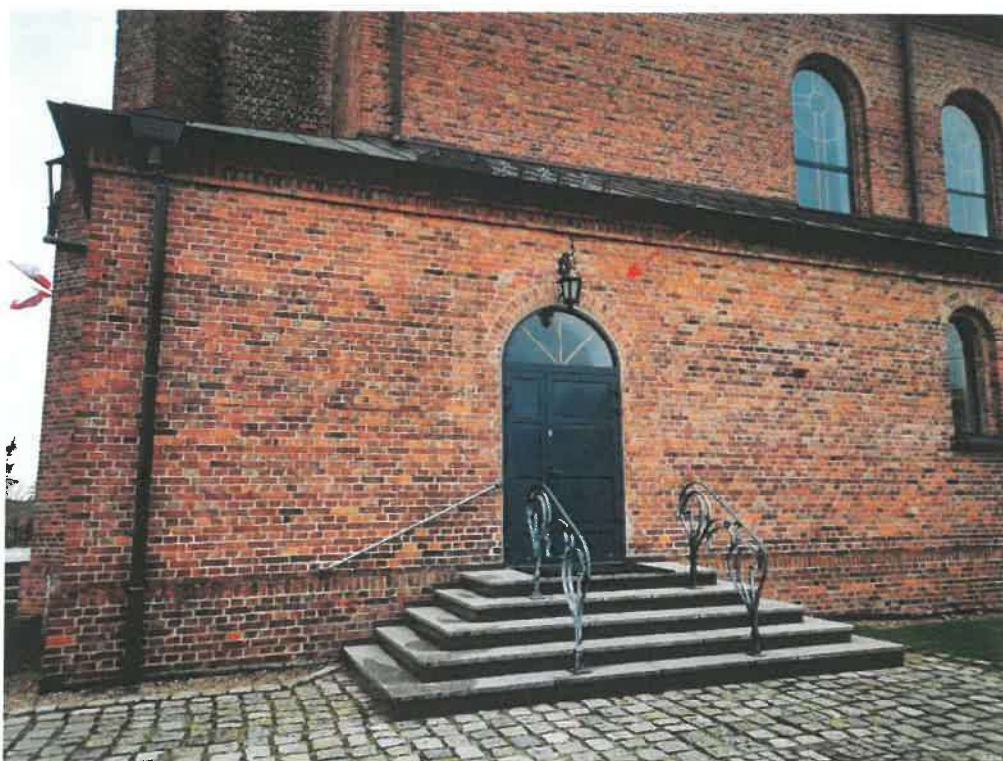
Zdj. nr 14 – Pęknięcie na ścianie zewnętrznej nawy bocznej
