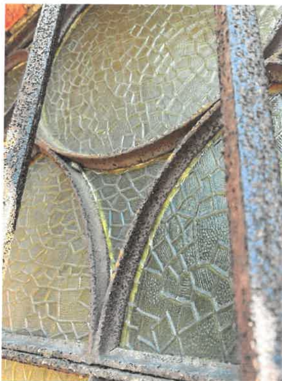
Zdj. nr 46 – Korozja elementów okna O8
