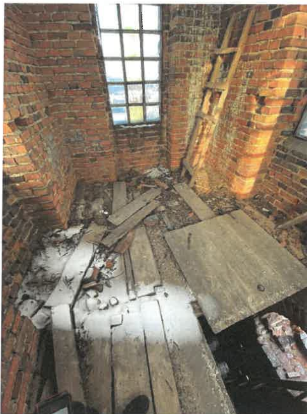
Zdj. nr 12 – Ubytki deskowania na podeście nad drugą kondygnacją wieży
