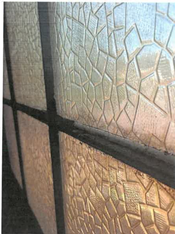
Zdj. nr 20 – Ubytki kitu i korozja elementów szprosów okien O1
