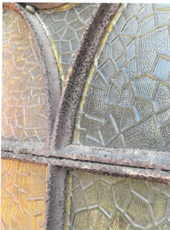
Zdj. nr 47 – Korozja elementów okna O8
