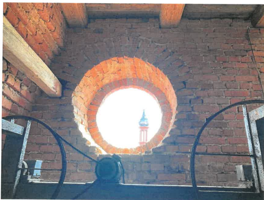
Zdj. nr 52 – Otwór w ścianie wschodniej wieży
