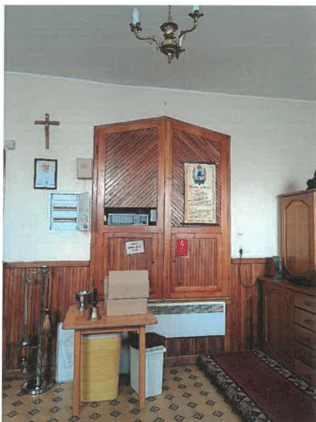
Zdj. nr 9 – Boazeria wtórna na ścianach w zakrystii
