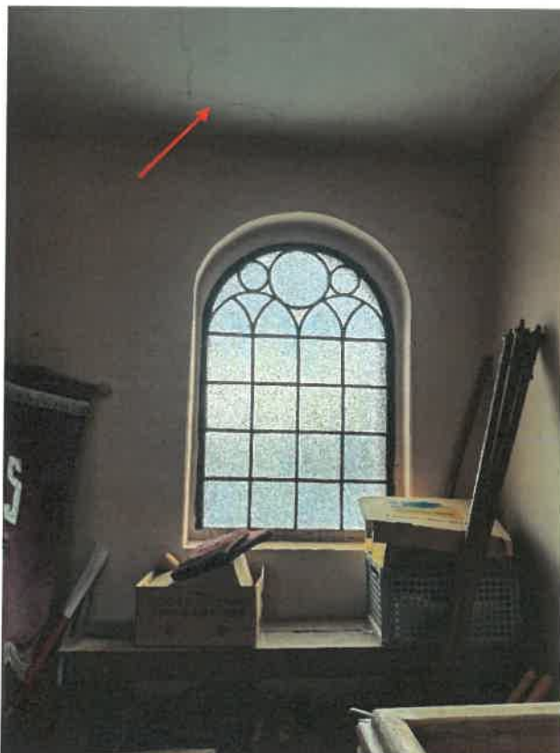
Zdj. nr 11 – Pęknięcie na suficie nad piętrem zakrystii
