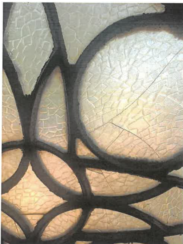
Zdj. nr 40 – Pęknięcia szyb w oknie O7
