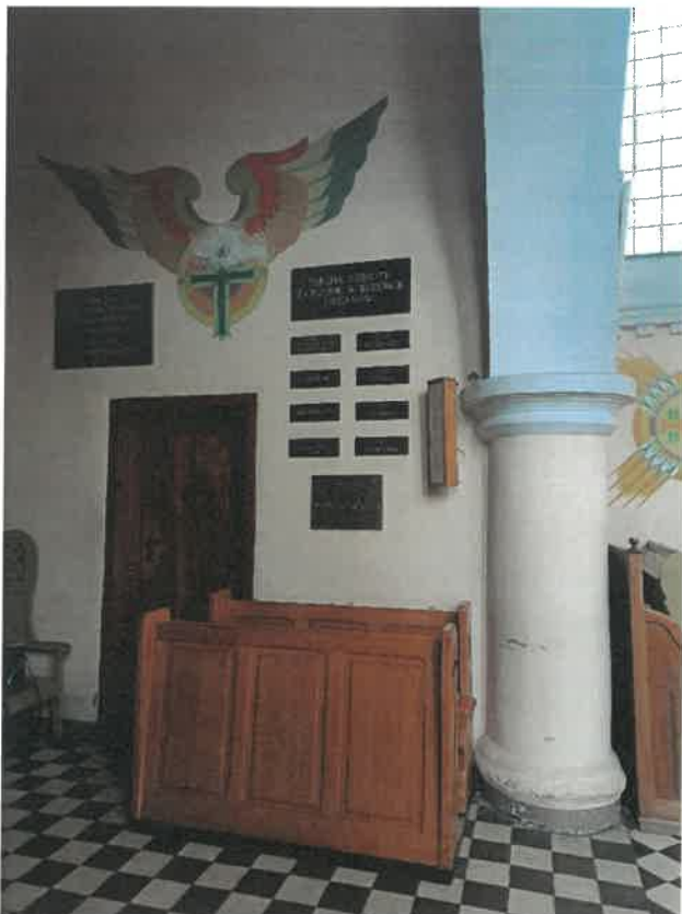
Zdj. nr 7 – Uszkodzenia i odspojenia tynku
