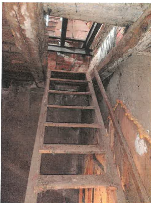
Zdj. nr 13 – Korozja biologiczna belek stropowych nad pierwszą kondygnacją wieży
