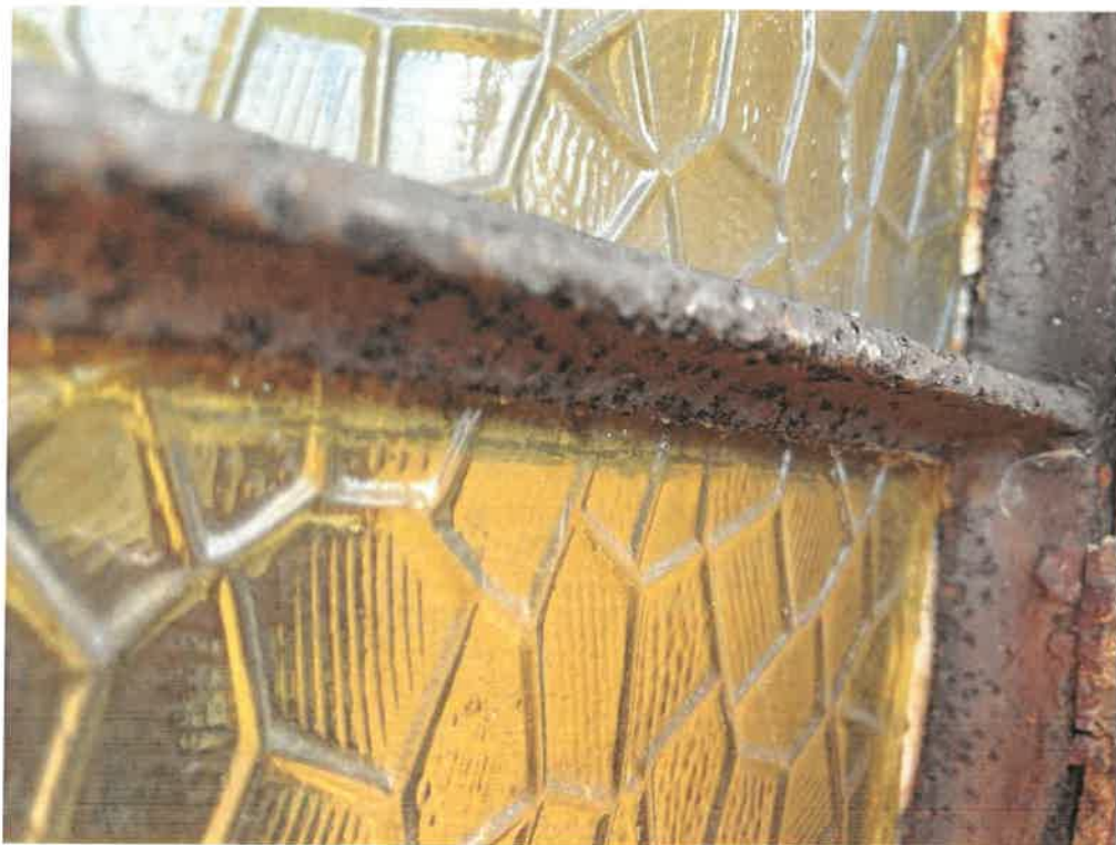
Zdj. nr 48 – Korozja elementów okna O8
