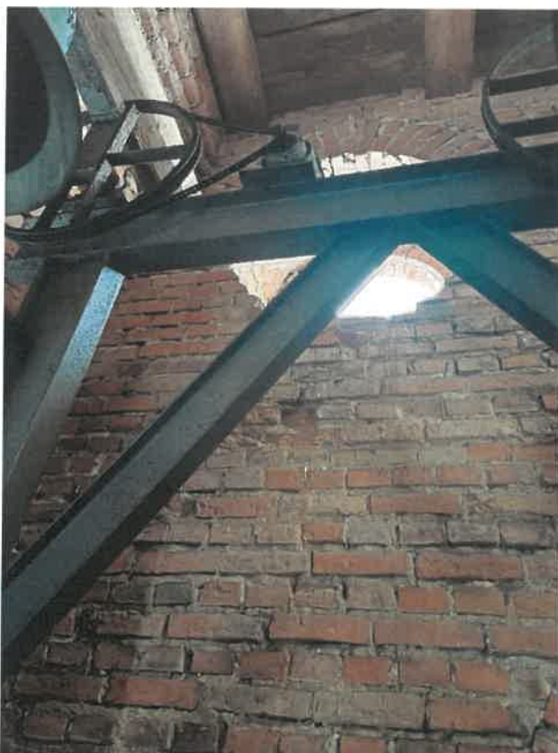
Zdj. nr 10 – Ubytki spoinowania i warstwy licowej cegieł
