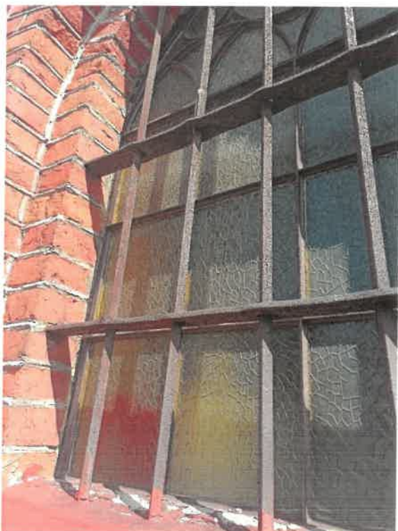
Zdj. nr 45 – Krata w oknie O8
